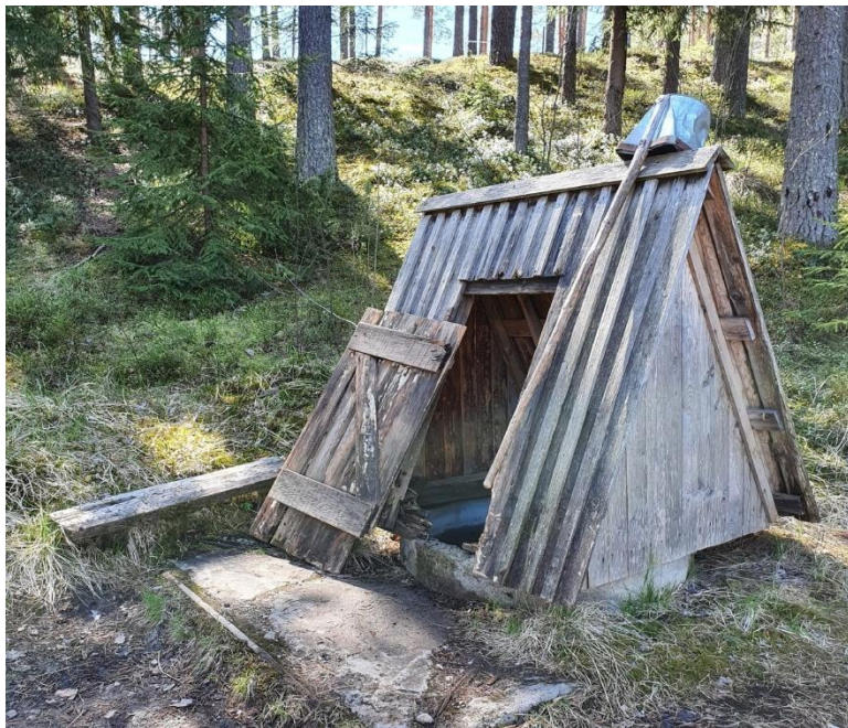
Фото до ремонта
